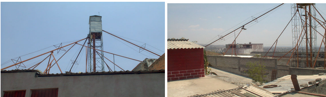
Detalles de la estructura del Molino Antigo de “La Asunción”. Intervenciones de finales del siglo XIX y mediados del siglo XX.
